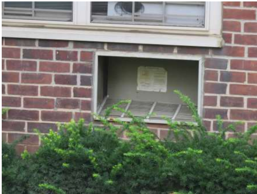
Loose AC grille
